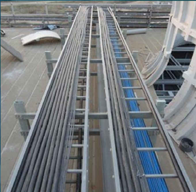
Cable Tray & Cable Ladder
